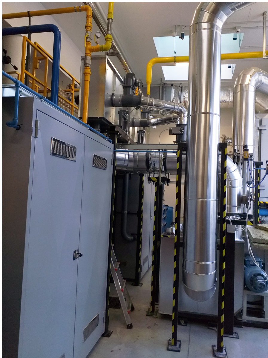
Gli impianti che provvedono all'abbattimento dei fumi
